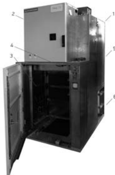
Рис. 3.17 Шкаф КРУ серии К-128 на номинальные токи 2000-4000 А 1 – корпус шкафа; 2 – релейный шкаф; 3 – отсек выкатного элемента; 4 – привод ЗР; 5 – линейный отсек; 6 – отсек сборных шин
