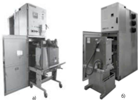
Рис. 2.1 Внешний вид шкафов КРУ серии К-129 «Оптима» а) с выкатом выключателя на инвентарную тележку б) с выкатом выключателя на пол
