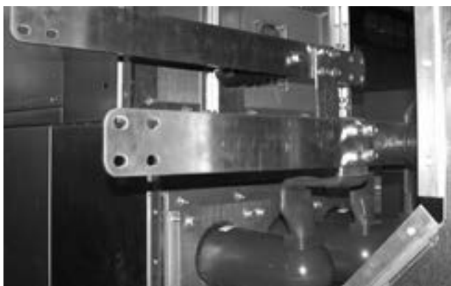
Рис. 1.6 Медные шины в отсеке сборных шин
