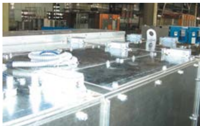
Рис. 2.2 Разгрузочные клапаны и концевые выключатели высоковольтных отсеков
