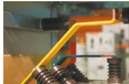
Рис. 1.4 Отсек сборных шин
