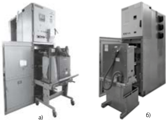
Рис. 2.1 Внешний вид шкафов КРУ серии К-129 «Оптима» а) с выкатом выключателя на инвентарную тележку б) с выкатом выключателя на пол
