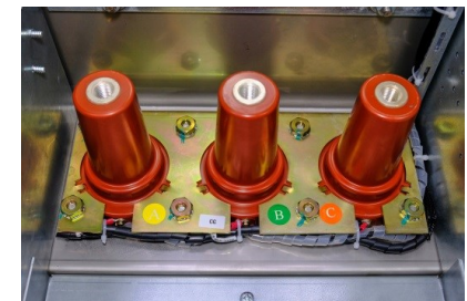
Бушинги в кабельном отсеке
