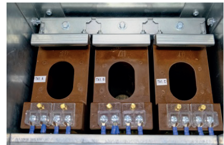
Трансформаторы, установленные в кабельном отсеке. Кабельный отсек функция V
